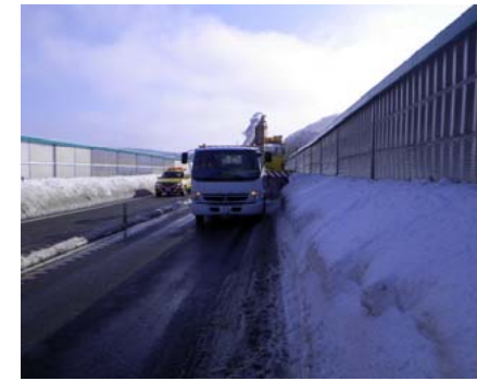
路肩の雪を排雪するために通行止が必要
