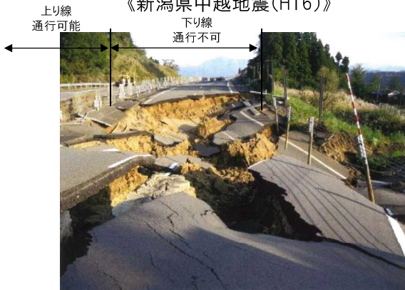
上り線を用いた対面通行により、緊急交通路確保
