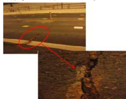
トンネルの変状による損傷例 (磐越道 鳥屋山トンネル)
