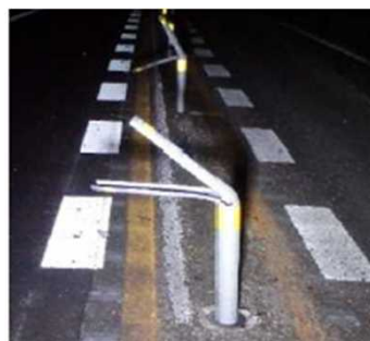
スリット部屈曲あり
