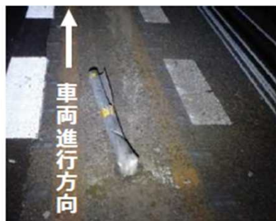
支柱基部は縦断方向に屈曲あり
