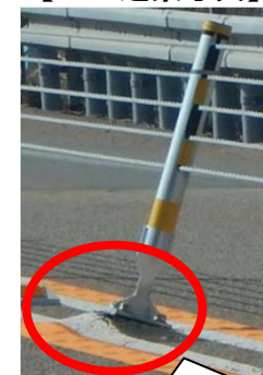
舗装の盛り上がり
