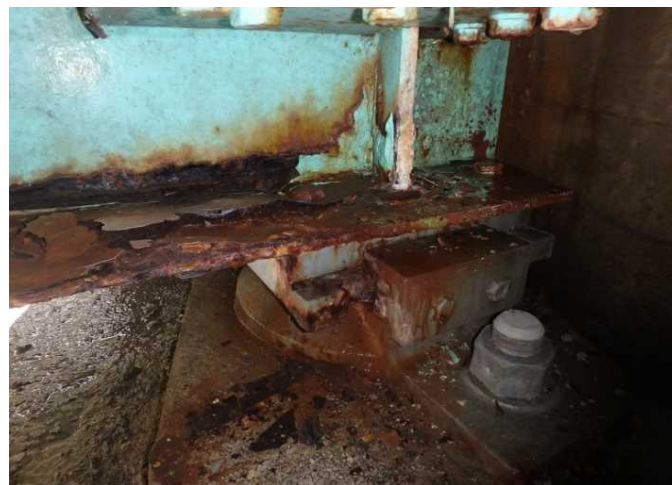
地方自治体管理 主桁腐食
