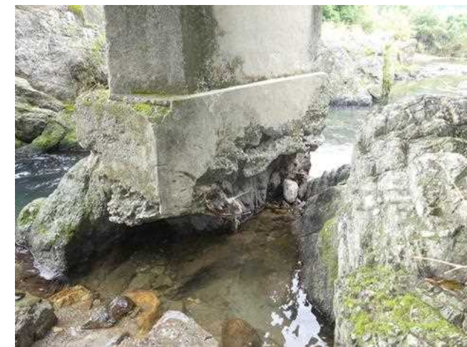
地方自治体管理 橋脚洗掘
