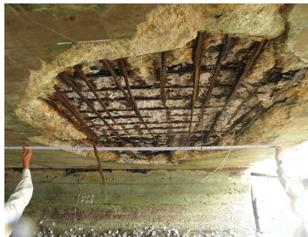
地方自治体管理 床版鉄筋露出
