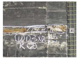
(写真)はく落跡
