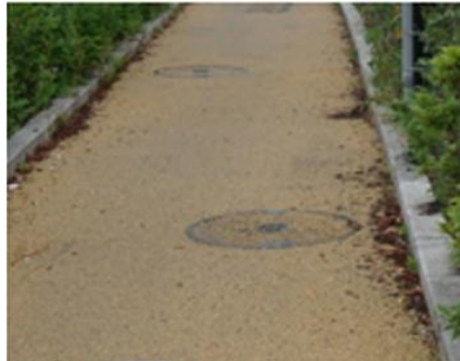
写真Ⅱ-4 マンホールの蓋に滑り止め加工した事例
