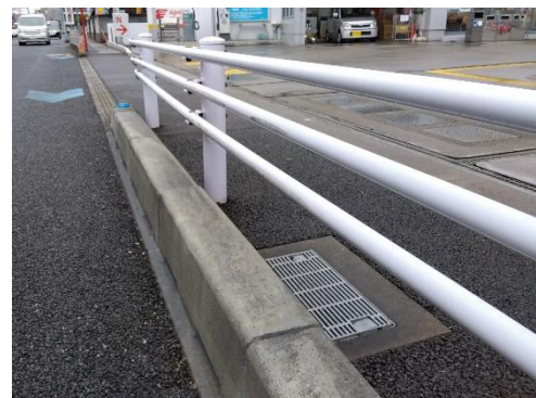
写真Ⅱ-2 歩道上の施設幅内に集水ますを移設した事例
