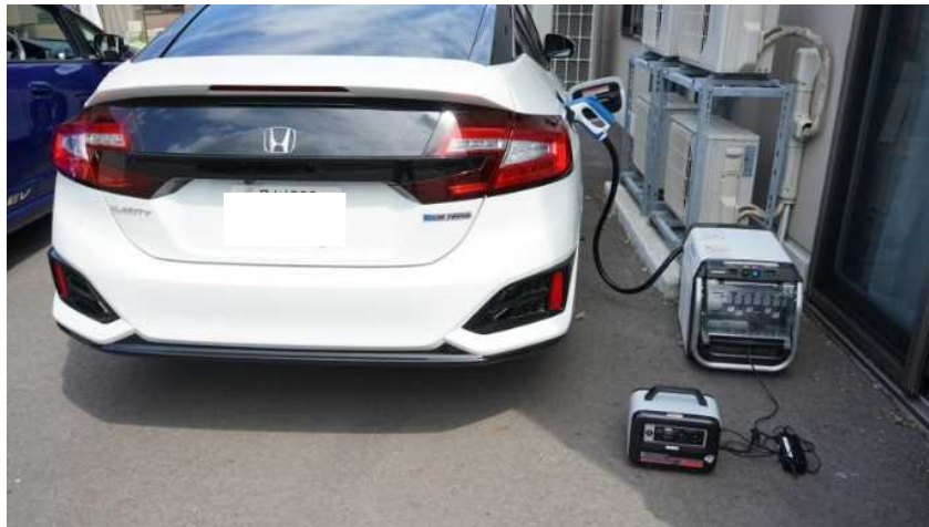
FCVからの給電：老人ホームでエアコンや小型蓄電池の充電に使用 出典：本田技研工業株式会社
