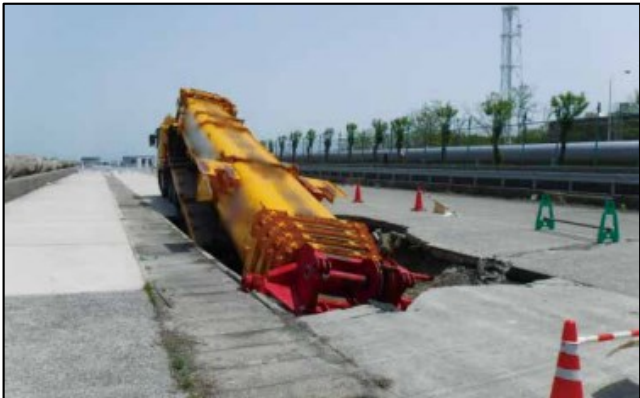
埋立護岸による陥没の発生状況
