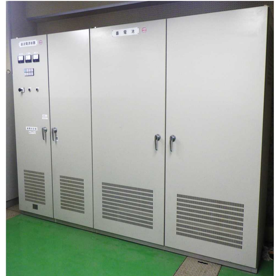
直流電源設備の例
