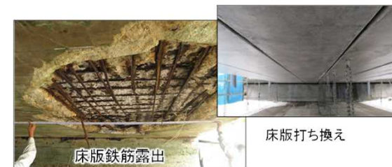
道路施設の老朽化対策
