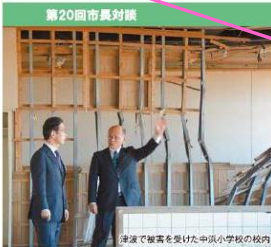
津波で被害を受けた中元小学校の校内
