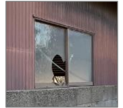
窓が割れた管理不全空家
