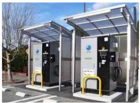
充電施設 蓄電池
