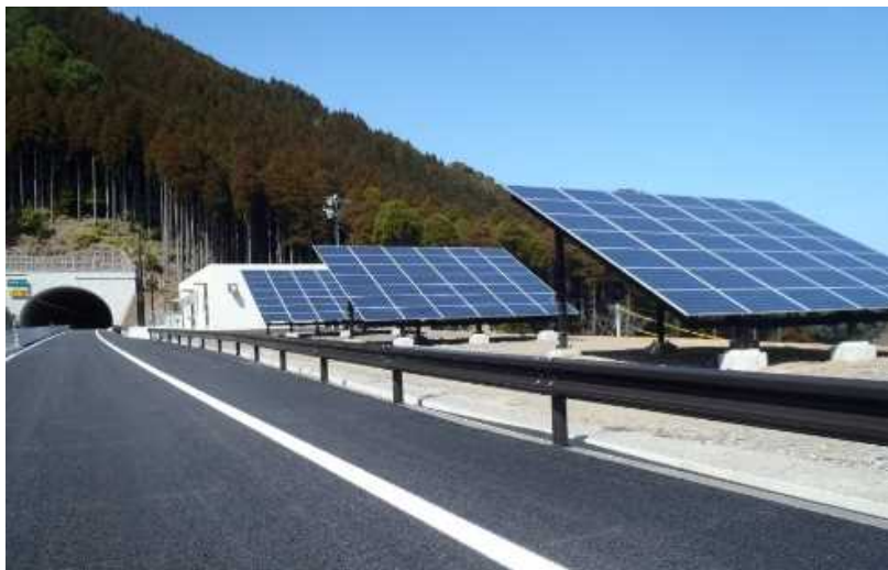
トンネル坑口付近における 太陽光発電設備設置事例
