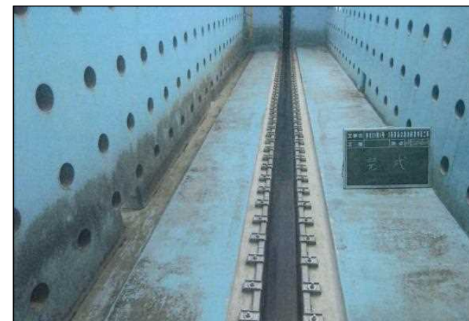
【薬物沈殿地の耐震目地伸縮可とう継手】
