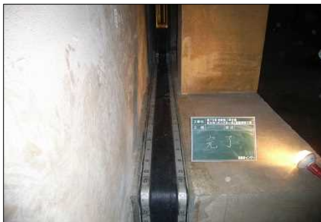
【可とう継手（ポンプ井と配水池）】
