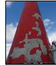
災害により損傷した灯台
