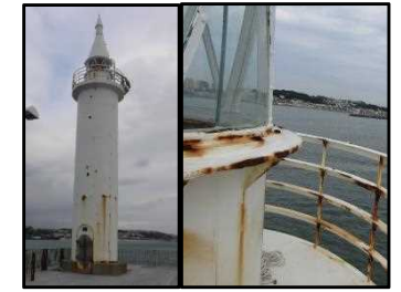
老朽化した灯台
