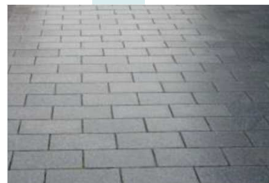
段差や境界線がない路面
