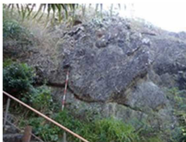
急傾斜地の落石危険箇所
