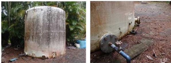
昭和47年に設置され、経年劣化により漏水が発生しているFRP水槽
