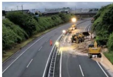
九州自動車道(横川~溝辺鹿兒島空港)の被害状況
