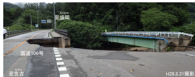
写真② 平成28年台風第10号での被災状況(当該区間)
