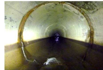
トンネルの内部状況 (継ぎ目からの地下水吹出し)
