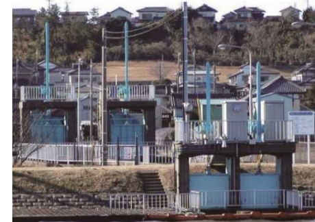
東総用水施設(水資源機構) S63事業完了
