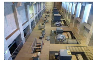
老朽化した横芝揚水機場
