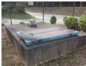
神崎町水道 古原浄水場水源1号井
