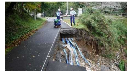
栃木県栃木市の被災状況調査(R1.10.18)
