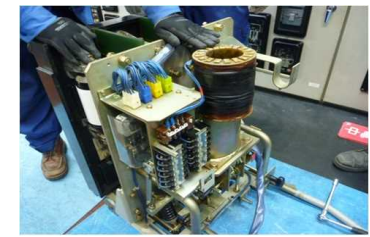
電気設備の焼損状況
