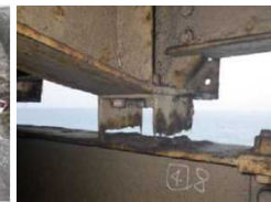
▲シェッド主梁端部破断
