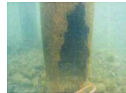
▲橋脚水中部の断面欠損
