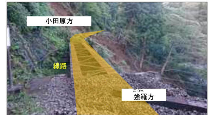
・箱根登山鉄道(宮ノ下～小涌谷): 橋桁流失
