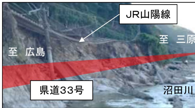
・JR山陽線で盛土崩壊等の被害が発生
