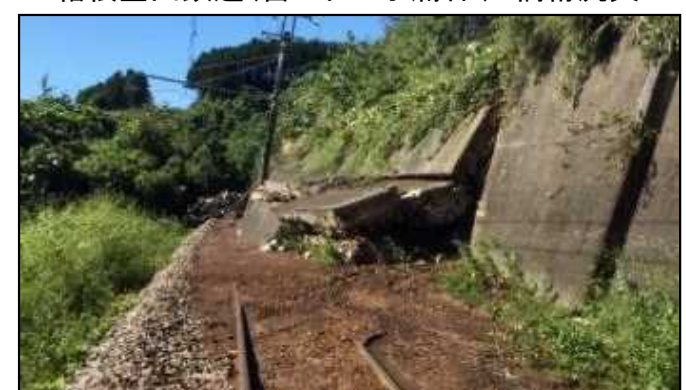
・JR東日本 中央線(高尾～相模湖): 擁壁崩壊
