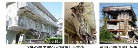
2階の廊下部分が崩落した事例 <左> 1階廊下天井が剥がれた事例 <中> 外壁が崩壊等した事例 <右>
