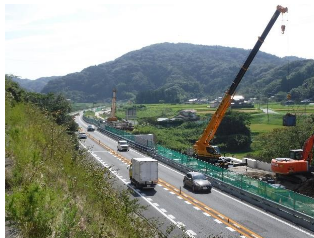
〈暫定2車線供用しながら4車線化工事を実施している状況〉 館山自動車道
