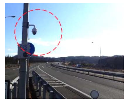
＜急こう配箇所の監視カメラ＞
