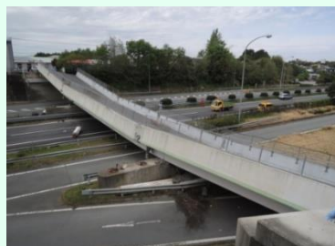
＜ロッキングピア橋の落橋＞
