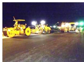
(老朽化した滑走路舗装の改良)
