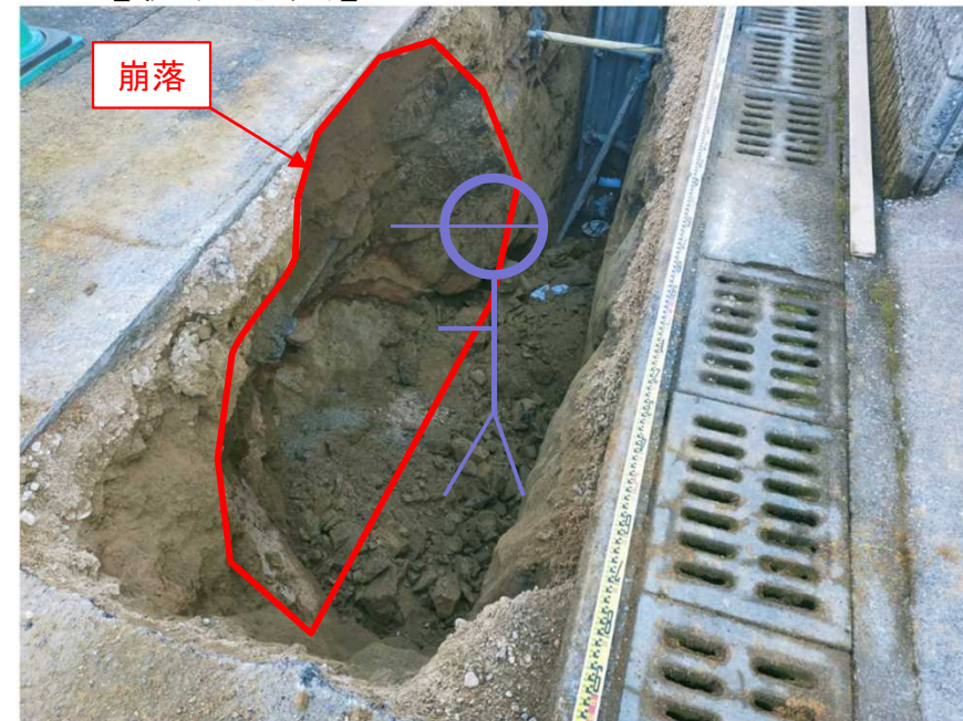
側面の岩塊が崩落し、作業員が埋められた。
