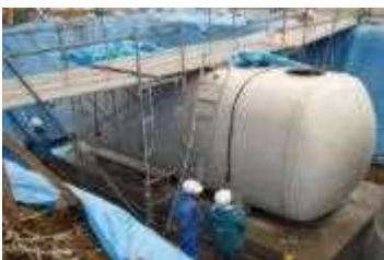
工場製作型 極小規模処理施設
