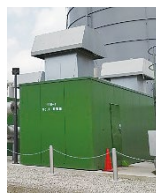
バイオガス発電機
