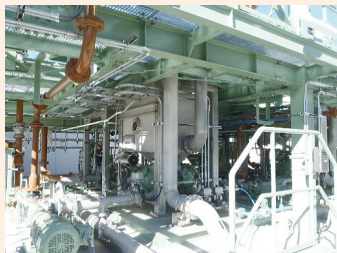
高濃度対応ろ過型濃縮機
