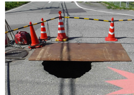
道路陥没 の発生
