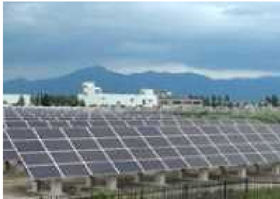
山形県 山形浄化センター
