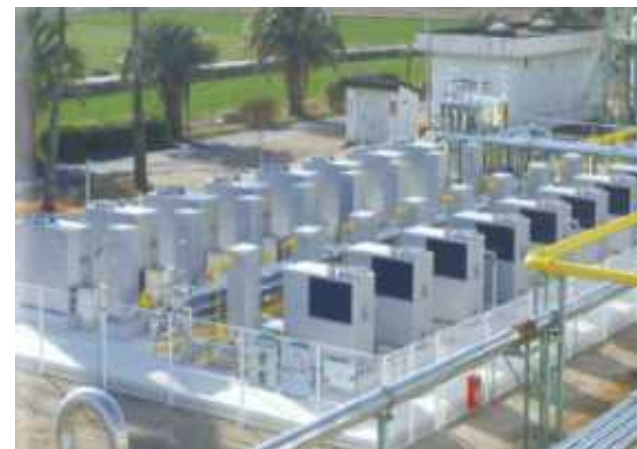
バイオガス発電
