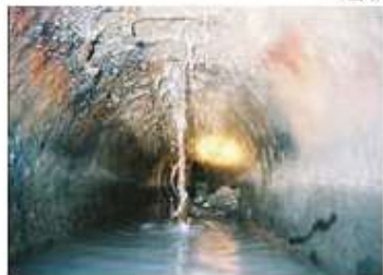
クラックからの浸入水
