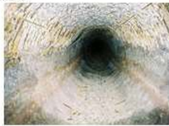
硫化水素による管路の腐食
