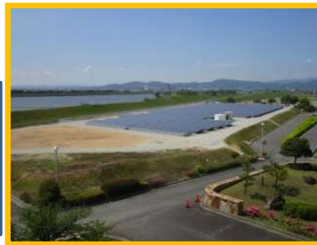
太陽光発電設備
