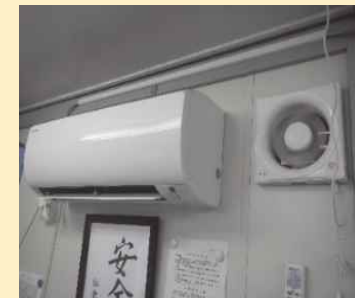
扇風機や換気扇とエアコンを併用
