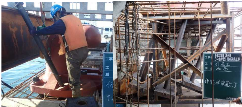
2000kN型(市販型)下部の設置状況 ※H28d清水港日の出岸壁(-12m)改良工事
