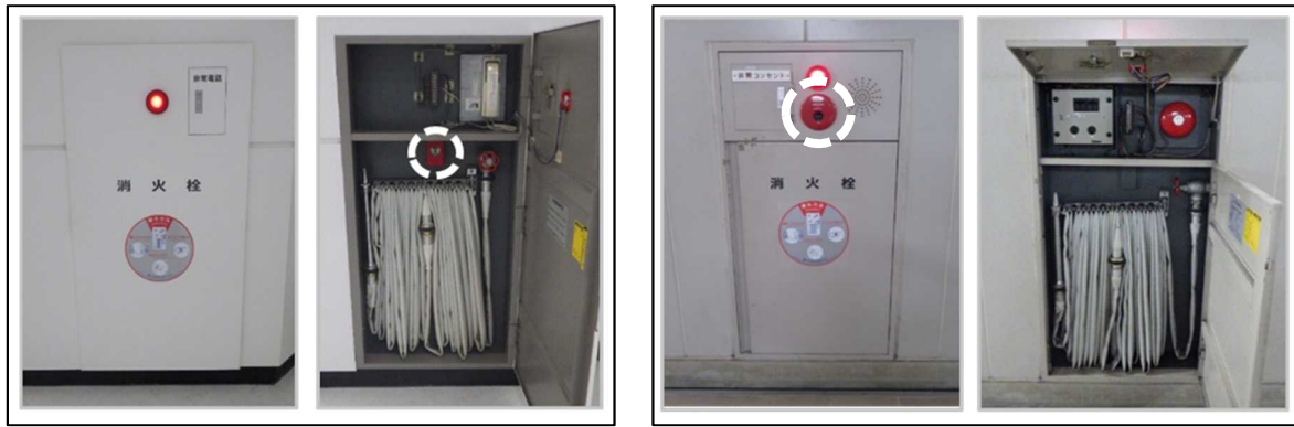
a. 消火栓内部に設置 b. 消火栓外部に露出
