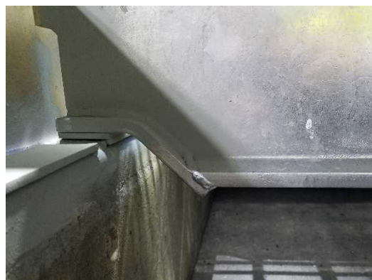
新設蓋ベースプレート
