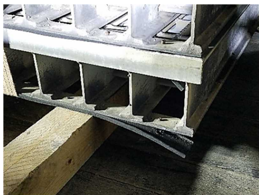
既設蓋ベースゴム破損部
