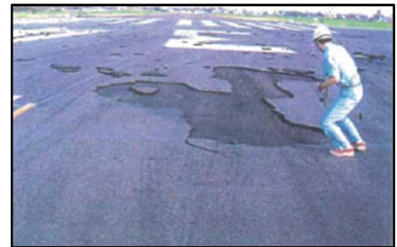
写真-2 アスファルト舗装の層間剥離
