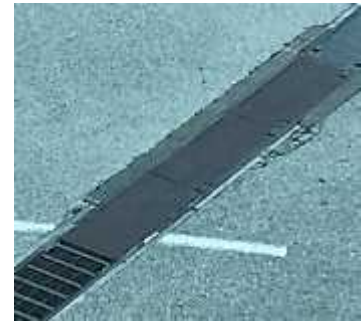
図 7. 既設のガタツキ・破損
