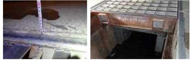
図 11. 既設グレーチングの状況
