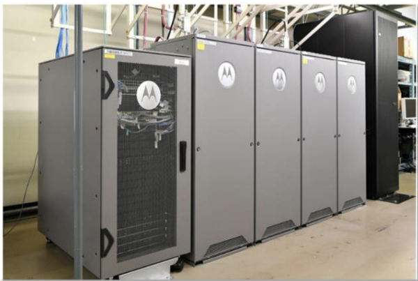
図 5 成田国際空港の TETRA 無線基地局
