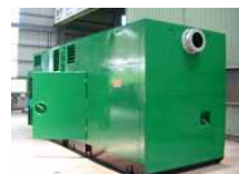
非常用発電機
