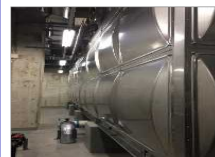
耐震性貯水槽
