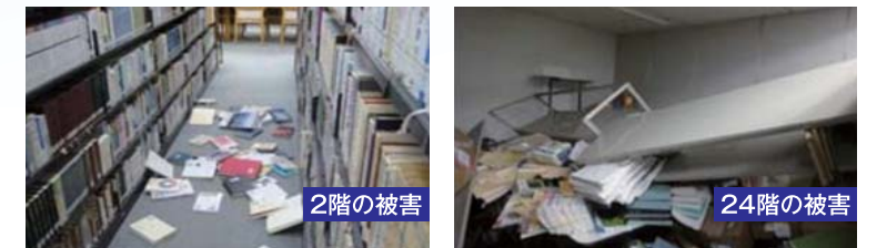
図表1 H23東北地方太平洋沖地震における超高層建築物の被害
