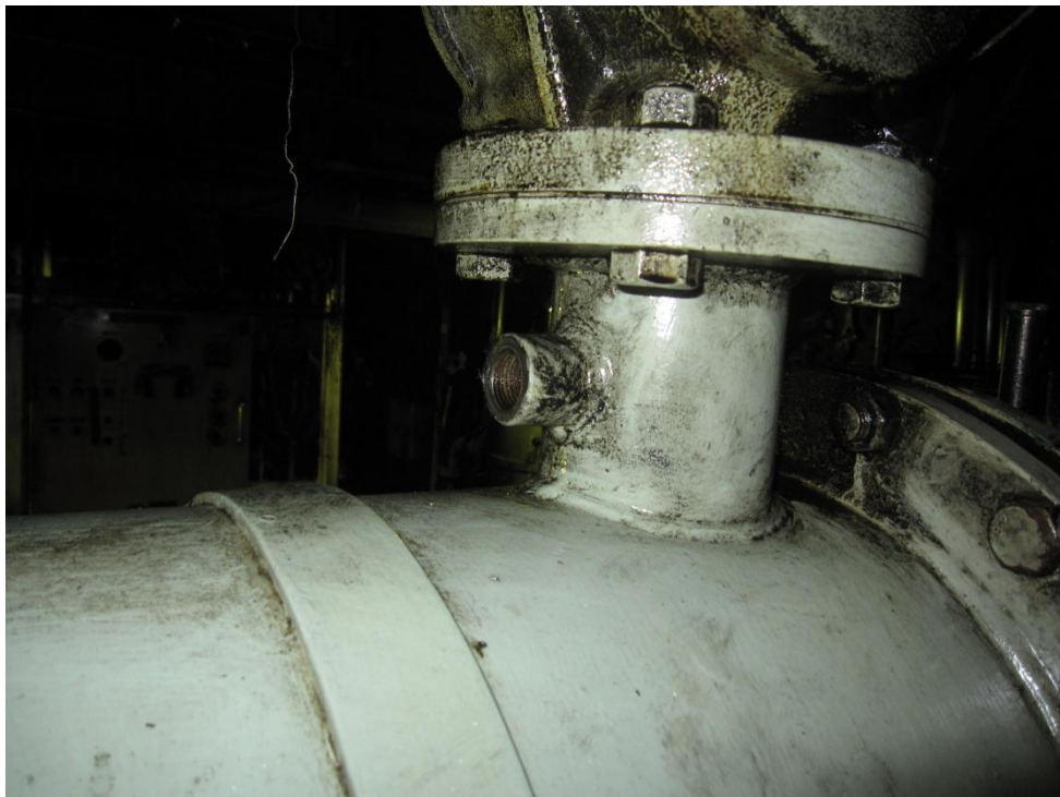
写真 1 1 主機潤滑油冷却器の潤滑油出口側温度計取付け座
