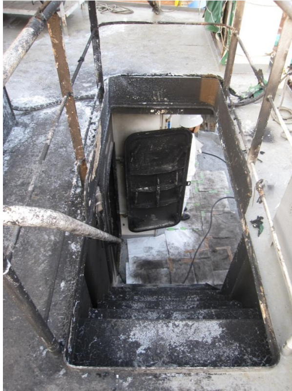
写真6 本件階段の焼損状況
