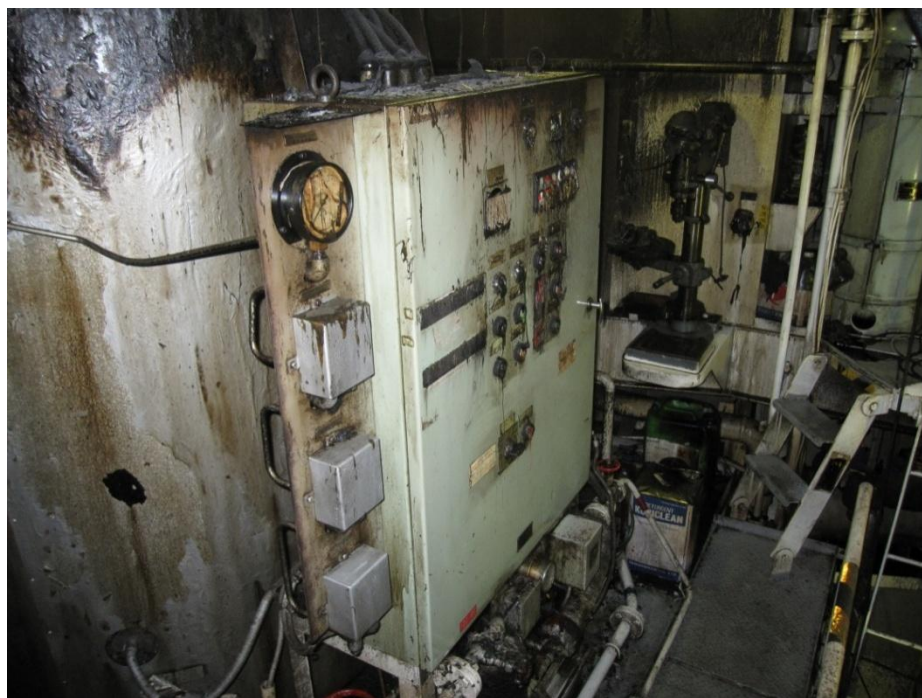
写真4 ボイラ制御盤
