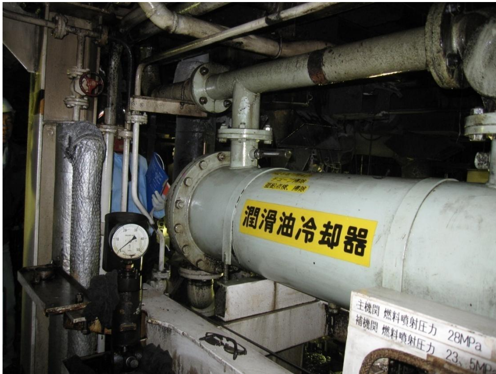
写真 1 0 主機潤滑油冷却器
