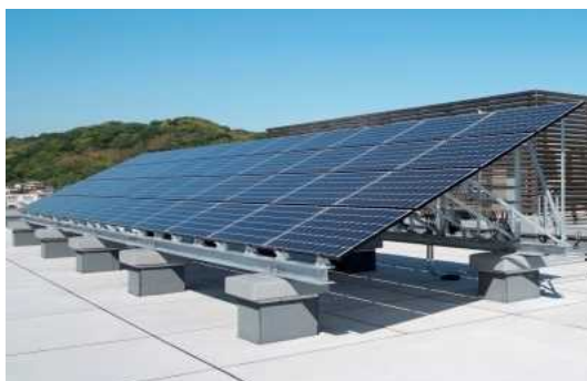
写真3 太陽光発電設備
