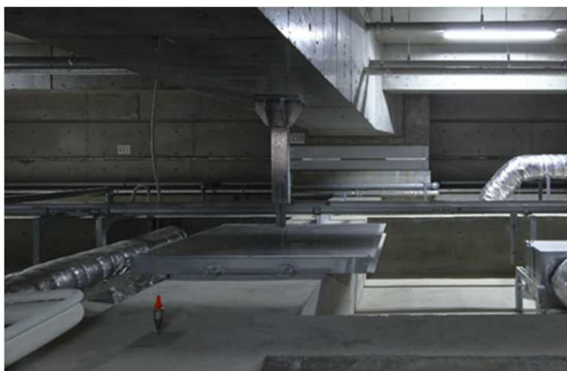
設備ルートを兼用する免振層
