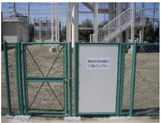
避難用出入口
