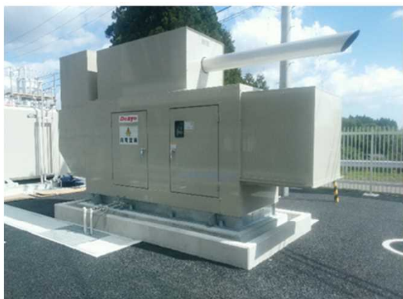
非常用発電設備
