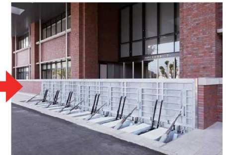
フラップ式浸水防止扉 (閉鎖時)
