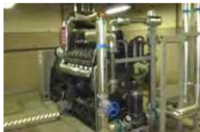
自家発電設備
