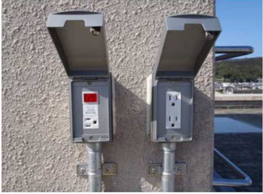
非常用コンセント
