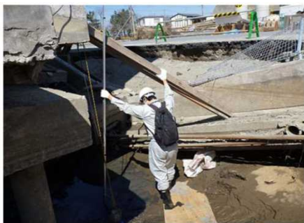
官庁施設の被災状況調査
