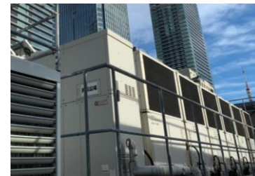
屋上の省エネ設備
