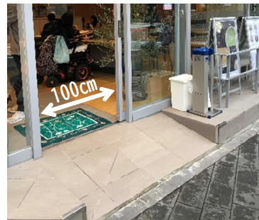
●改修による自動式引き戸の設置、出入口前後の高低差の解消
