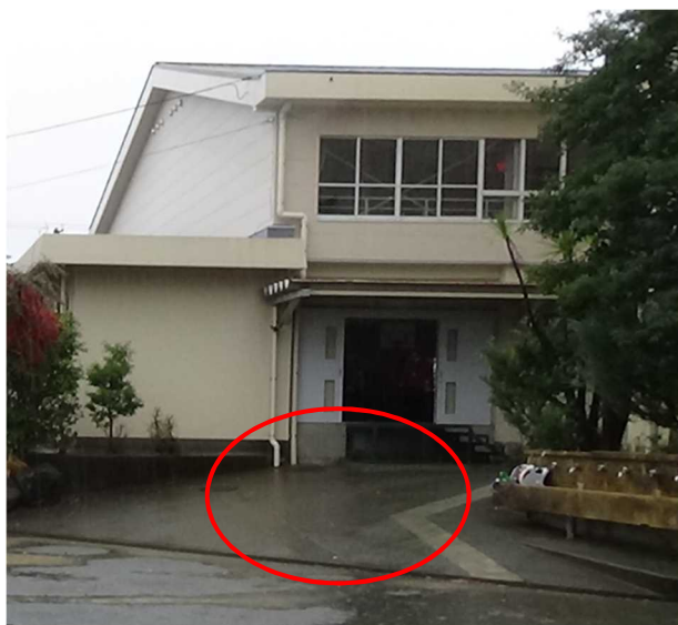
図表Ⅱ－3－18 荷役スペースの傾斜状況
