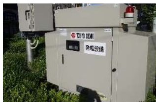
非常用発電機
