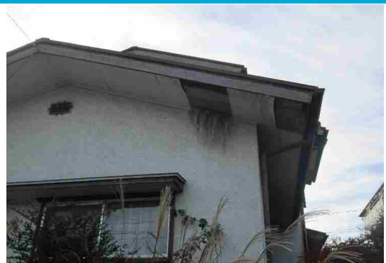
写真1: 軒裏からハクビシン等が侵入している可能性がある。
